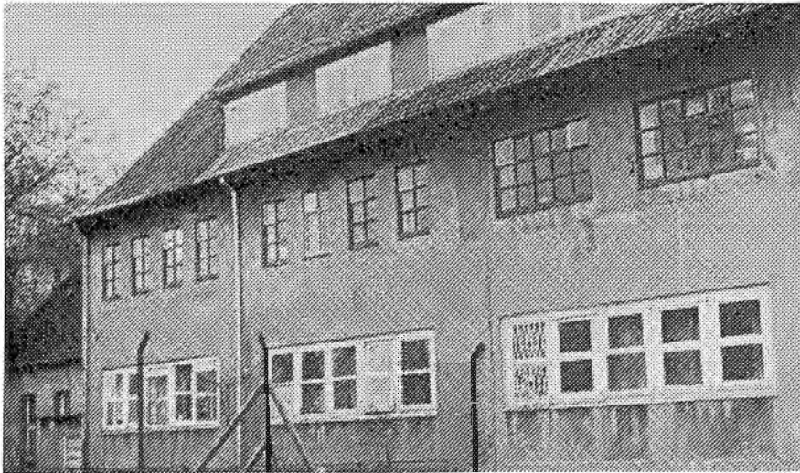
Wohnlager Knabenweg – ehemaliges Jugendheim, schlechte Bausubstanz
